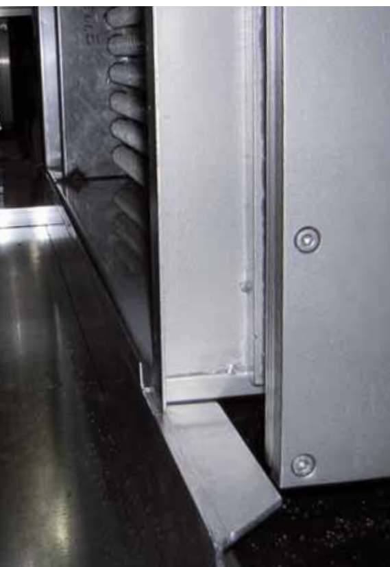
Particolare supporto batteria elettrica
