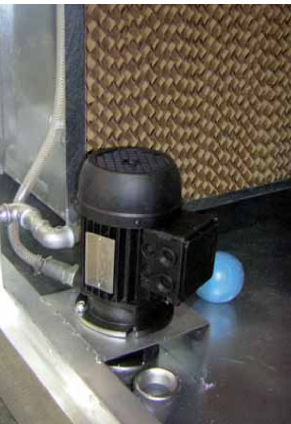
Particolare pompa per umidificazione adiabatica
